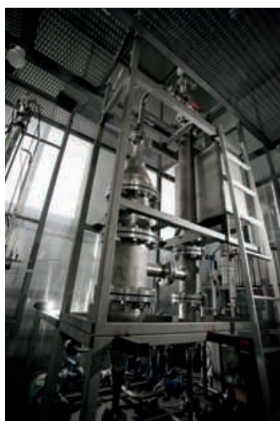
Фото 6. Установка для исследования процессов сероочистки газов
