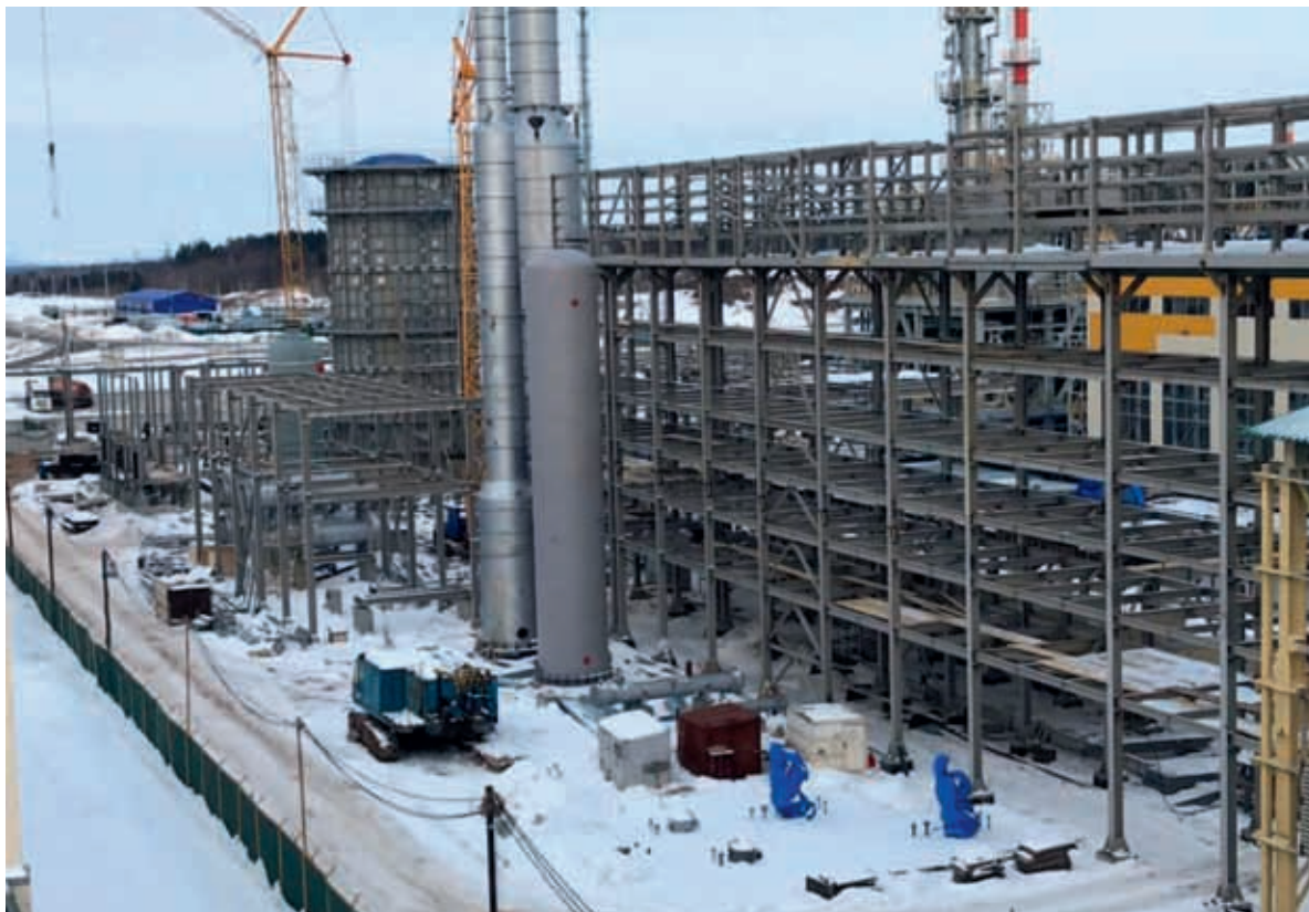
Секция 4106 – Установка изодепарафинизации дизельного топлива
