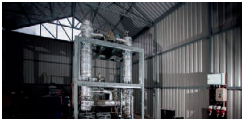
Фото 5. Выпарная установка с тепловым насосом
