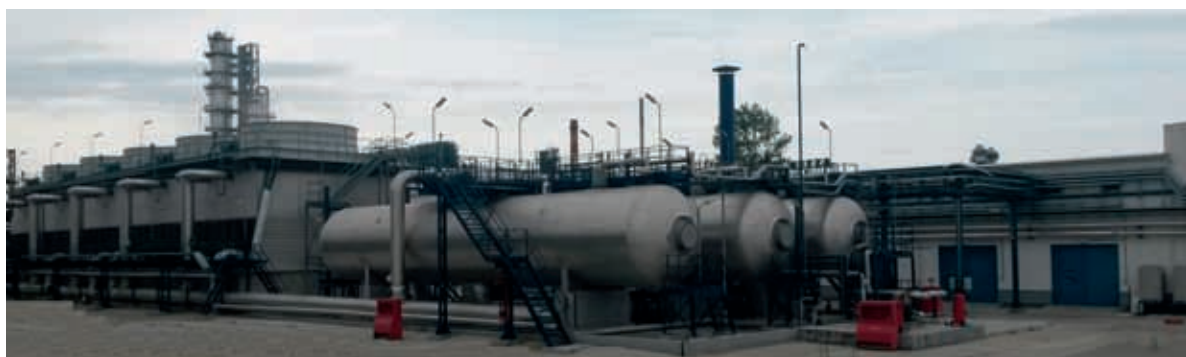
Рис. 3. Блок оборотного водоснабжения БОВ-6
