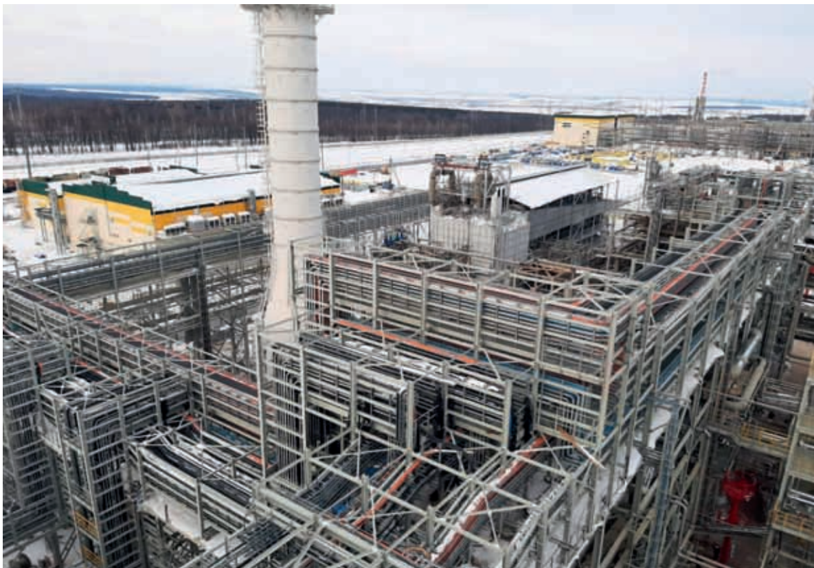
Секция 3102 – Установка производства водорода
