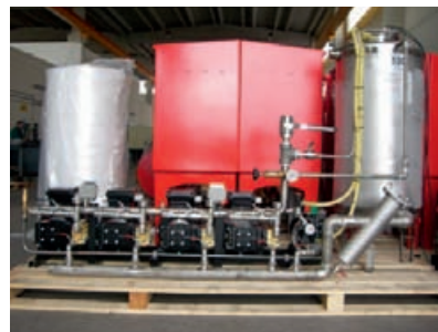
Насосный узел на раме в помещении
