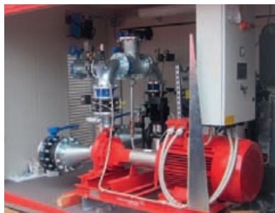
Насосный узел на раме в контейнере
