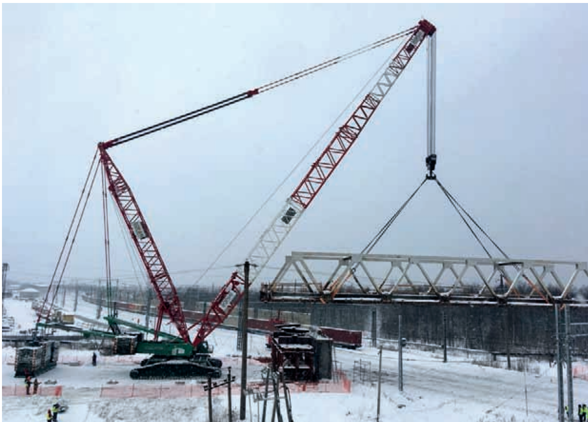
Демонтаж фермы пролетного строения автомобильного моста над ж/д путями, кран LR 1750, Ленинградская область, пос. Мга
