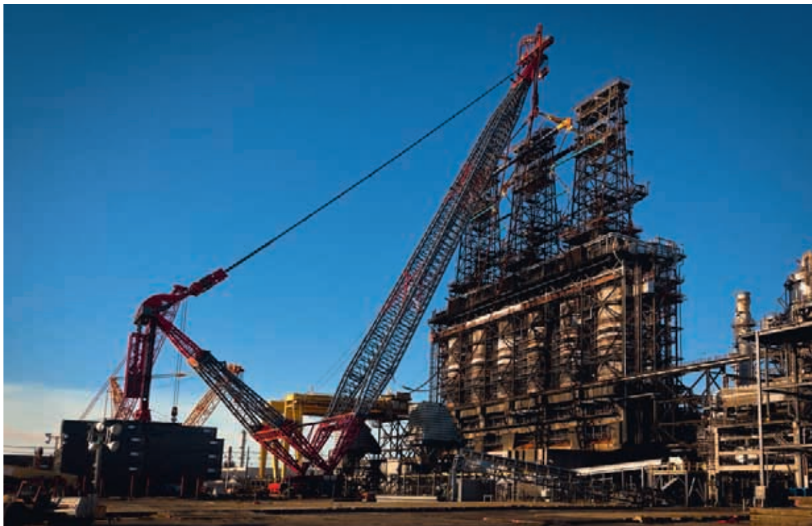
Рис. 16. Подъем этажерки массой 1400 т при помощи крана AL.SK190, проект Valero, США, 2011 г.
